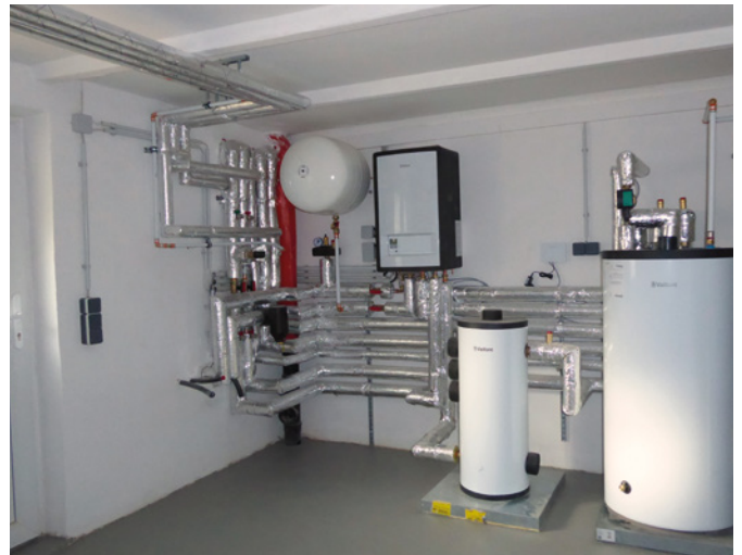
In der Eugen-Jäger-Straße 29 sorgt eine Wärmepumpe für Heizung und Warmwasser
