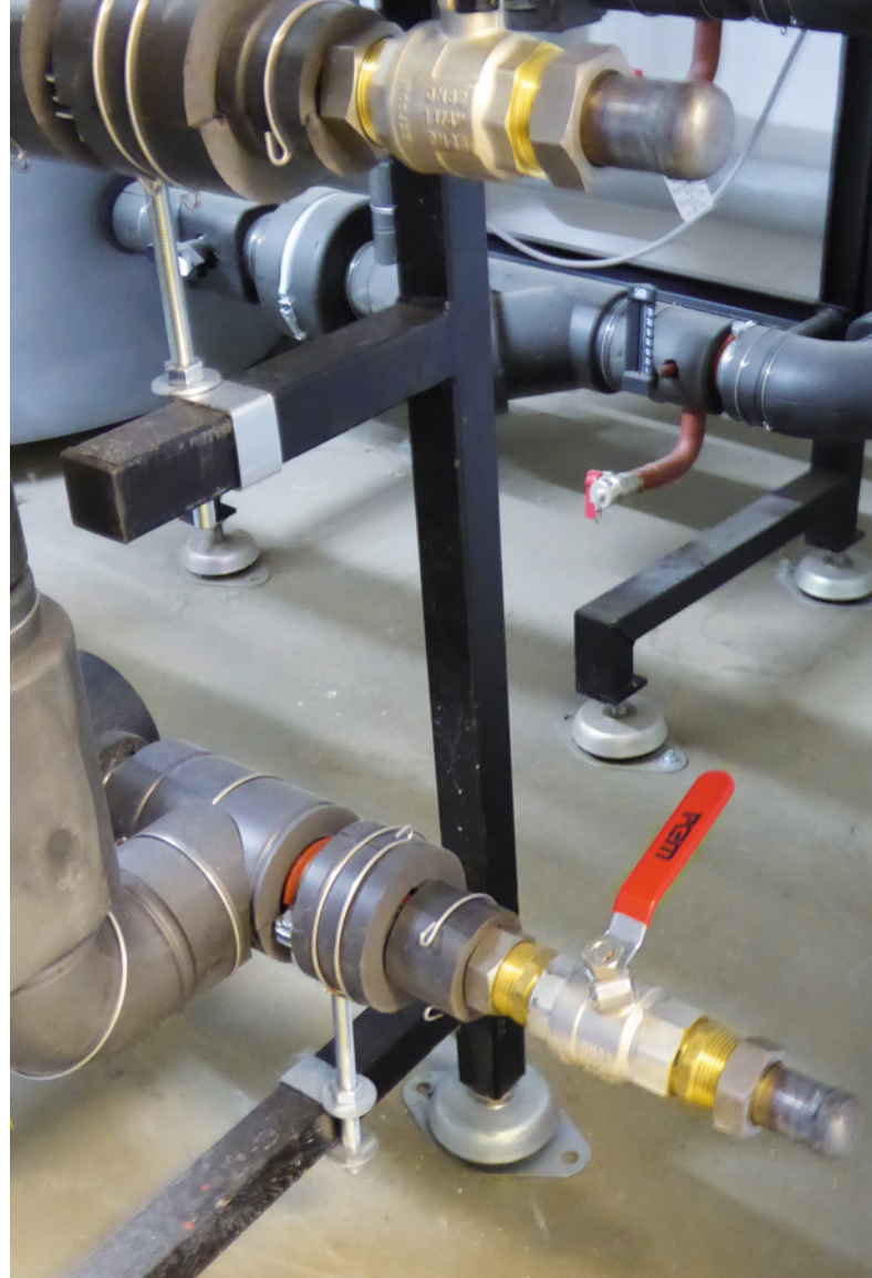
Eine der Strategien zur Dekarbonisierung: der Anschluss an die Fernwärme, hier im Ziegelofenweg 48
